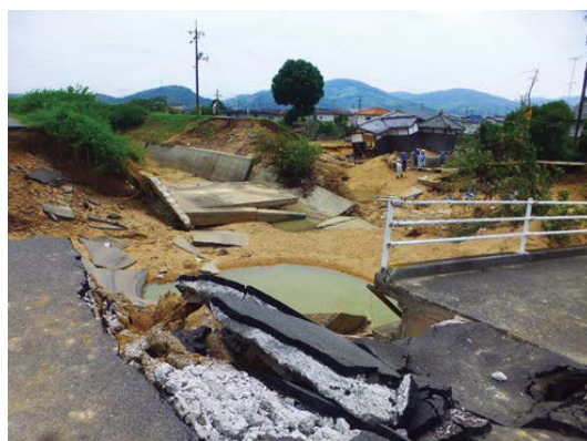
写真-1 末政川の堤防決壊箇所
