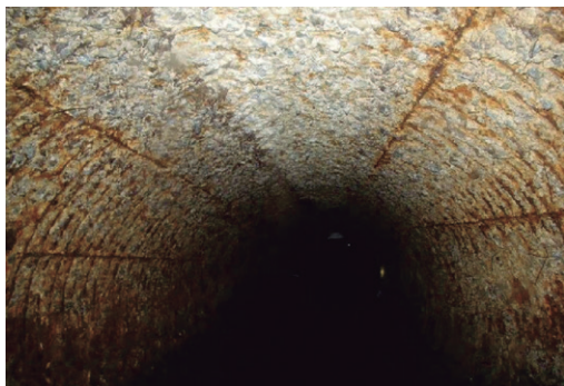
下水管の老朽化（鉄筋露出）
