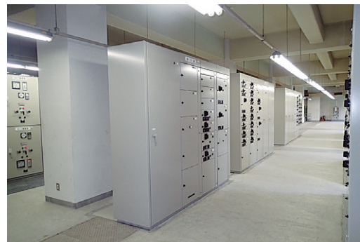
改築更新後の電気設備
