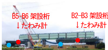
センサー設置状況
