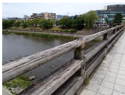
老朽化した木製高欄
