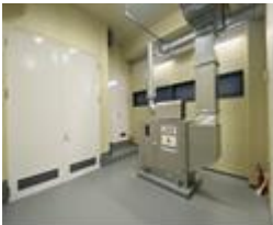
写真-⑨ 非常用電源
