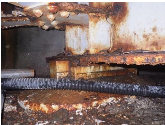
【補修前】 支承部の 腐食状況
