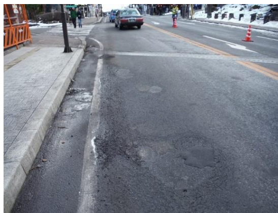
【補修前】 終点側 下り線の 橋面劣化 状況
