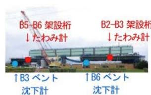
センサー設置状況
