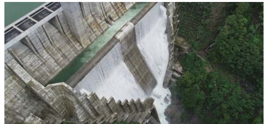
側水路からの溢水状況
