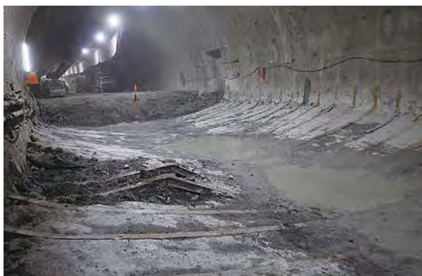
インバートストラットの座屈状況
