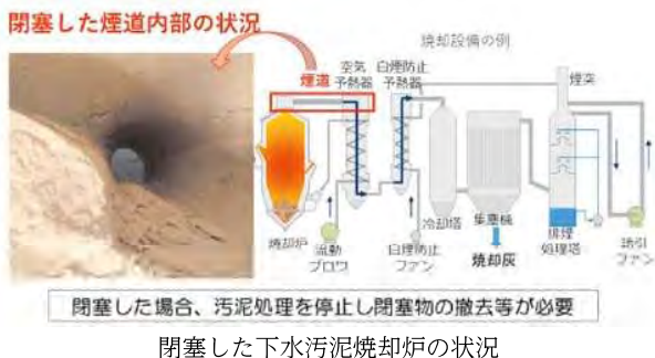
閉塞した下水汚泥焼却炉の状況
