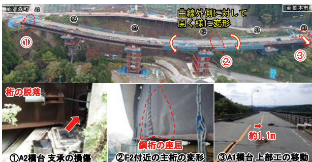
大切畑大橋の主な損傷状況
