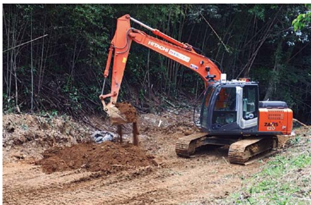
平成 29 年 6 月大分県豊後大野市の地滑り災害現場
