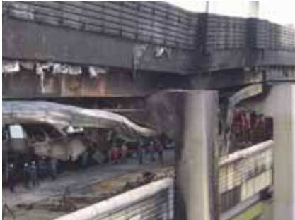
火災鎮火状況
