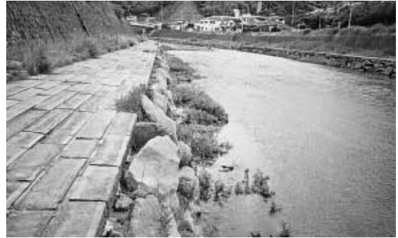
自然石護岸の植生回復状況
