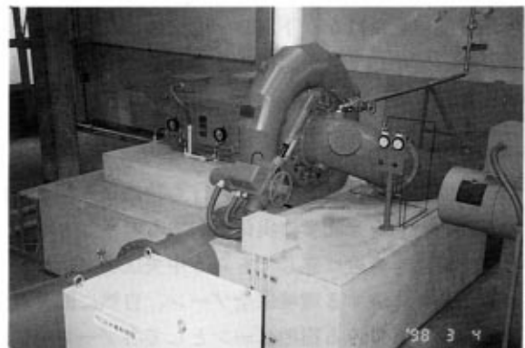
横軸単輪単流渦巻フランシス水車と三相誘導発電機
