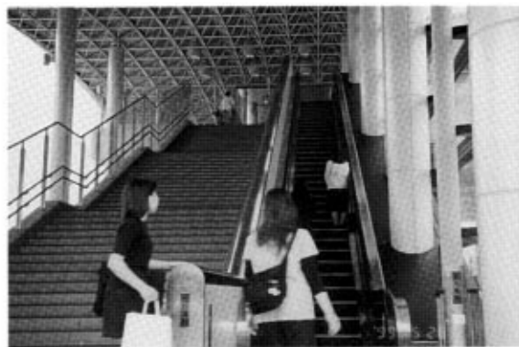
エスカレーター(安全性に配慮した音声による案内)
